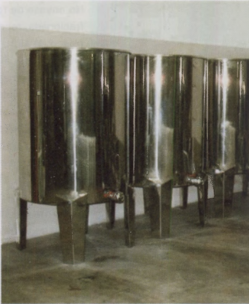
Fig. 13. Decantadores de aço inoxidável.
